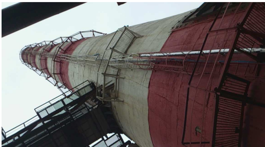
Рисунок 5.5 – Пример некорректного проектного решения: пробоотборная линия выше 60 метров с температурой подогрева ниже точки росы дымовых газов
