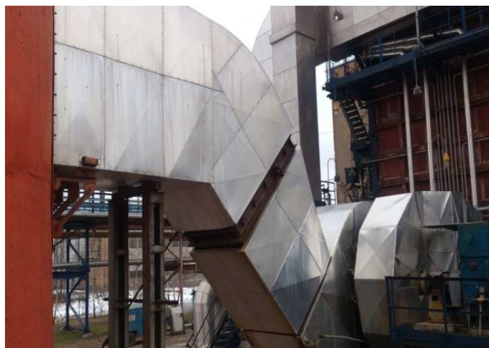
Рисунок 5.3 – Пример газохода, на котором оборудована точка производственного экологического контроля, не соответствующая требованиям по длине прямолинейного участка
